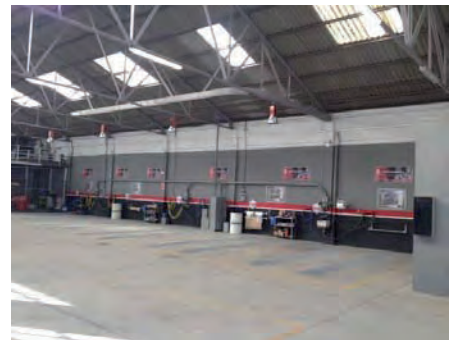
ZONA DE ASPIRACION Y LIJADO
